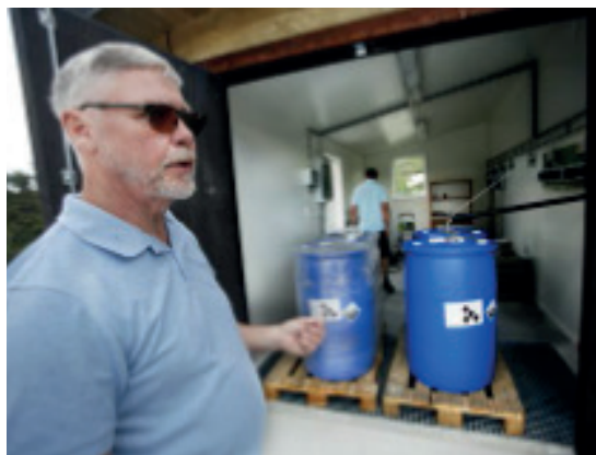
Christer Malmqvist visar teknikhuset där man förvarar fällningskemikalier och reningsverkets blåmaskiner och styrning.
