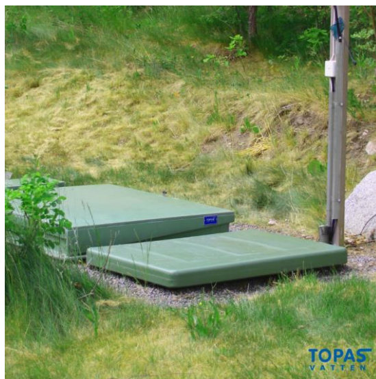
Minireningsverket Topas 8 med automatisk slamavvattnare
